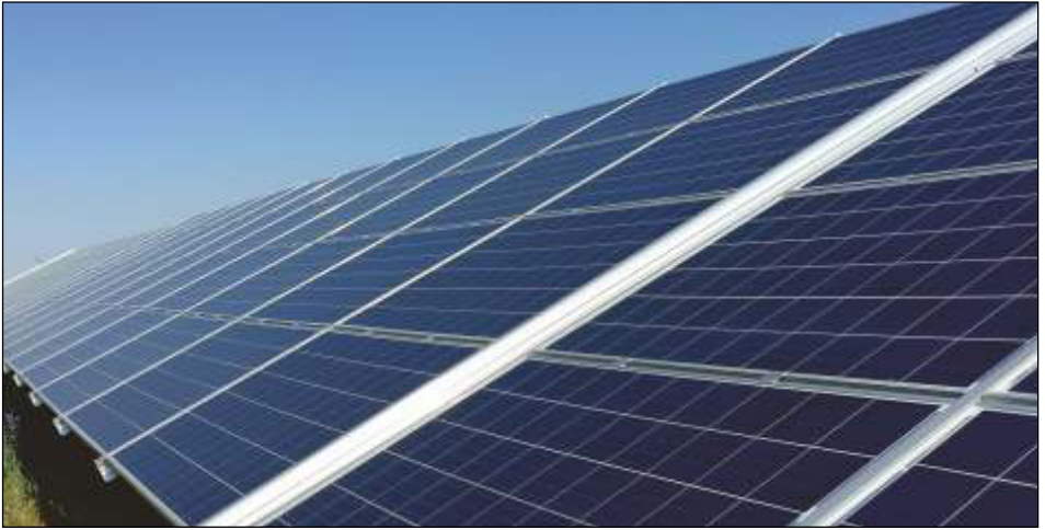
Solarmodule auf Freiflächen.
